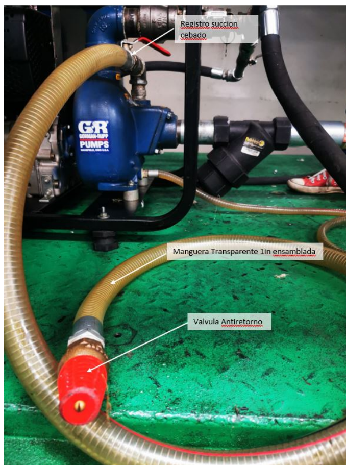
Figura 26: Línea de Purga bomba
