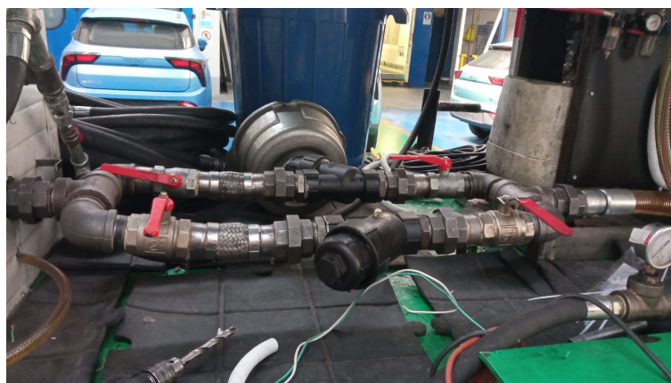
Figura 31: Filtros Y en Bypass
