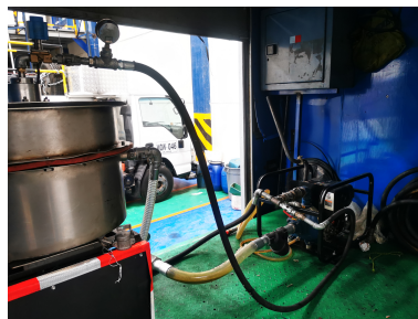
Figura 20: Manguera de 3/4in entre la bomba y la centrífuga
