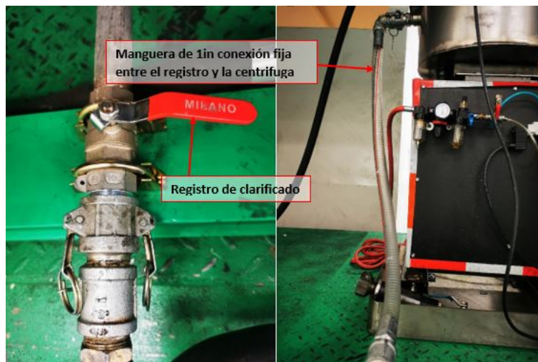
Figura 18: Línea de clarificado. a) Registro de clarificado, b) Manguera de 1in conexión fija entre el registro y la centrífuga
