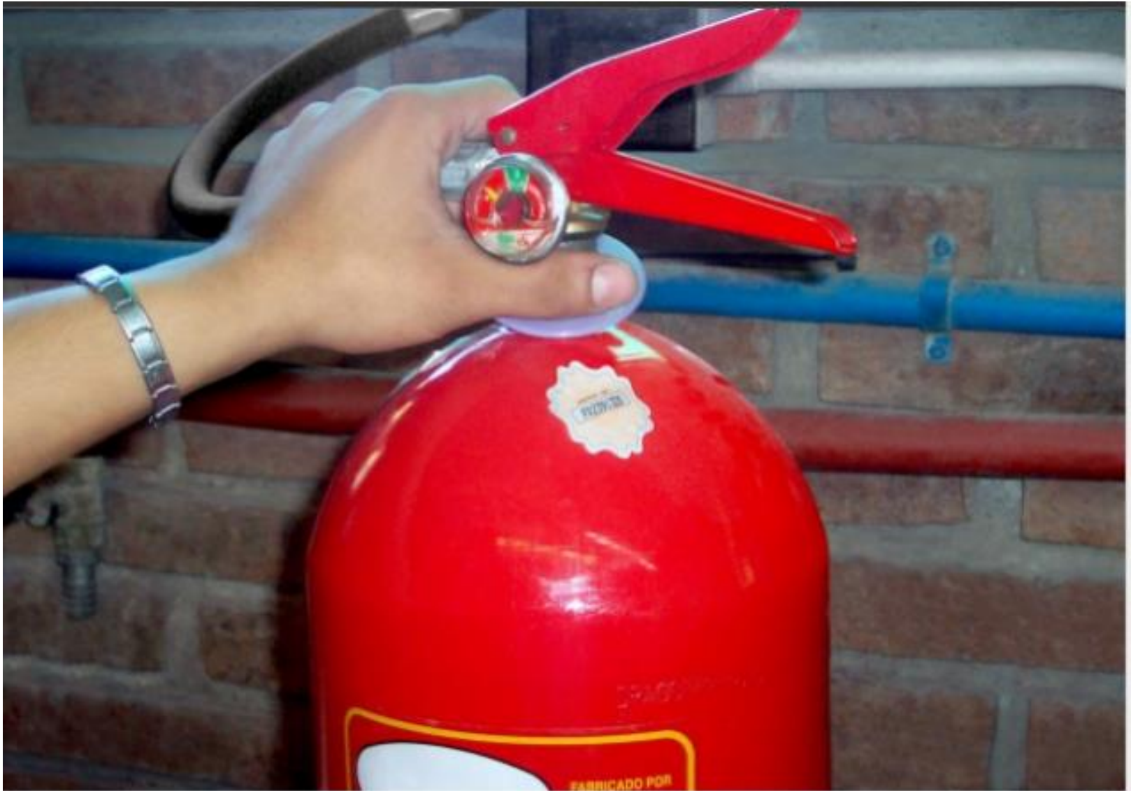
Condición insegura – Extintidores descargados
