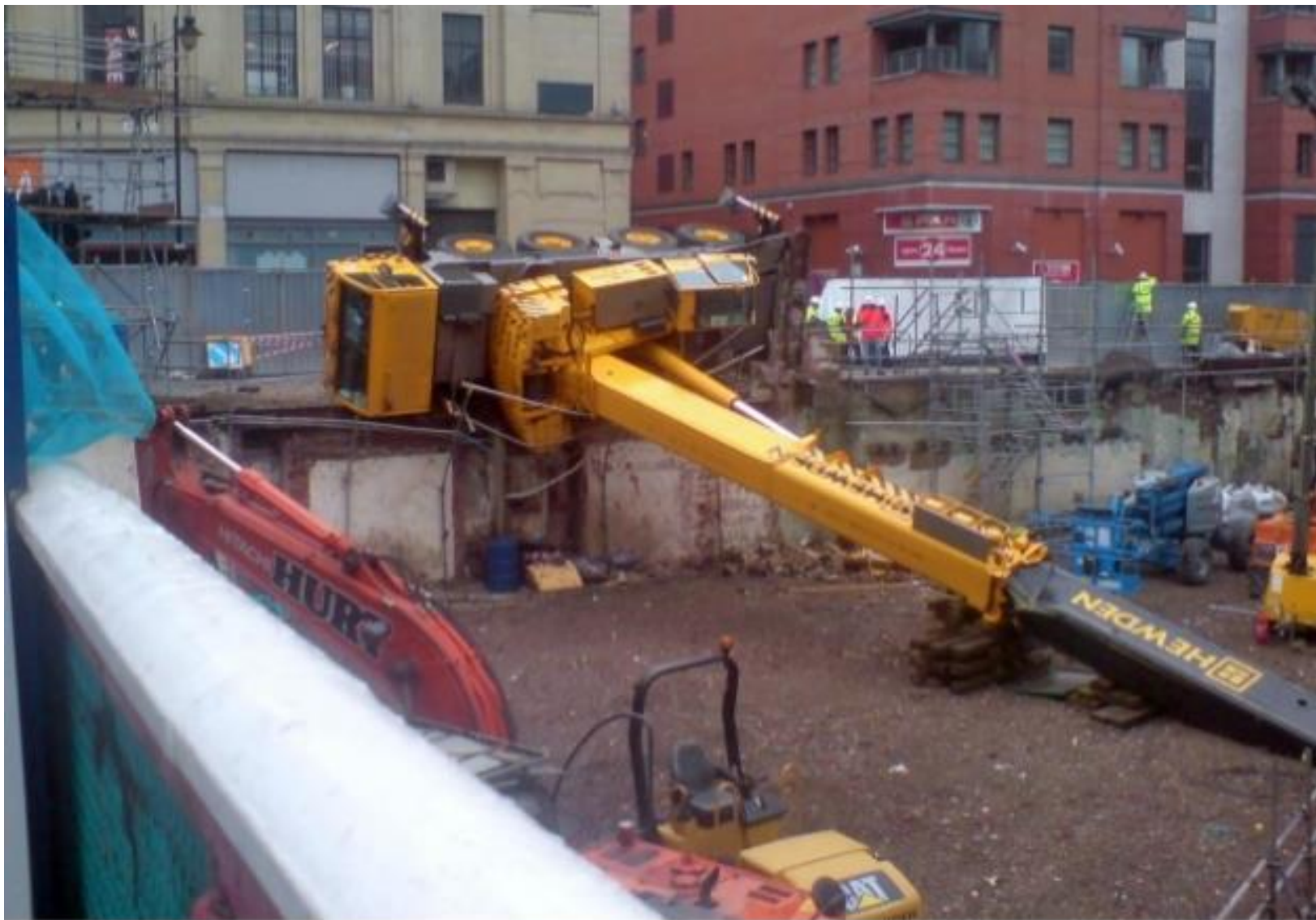
Acto inseguro – Usar grúa de manera incorrecta
